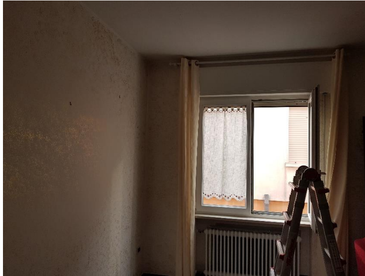
Punto di installazione in soggiorno
