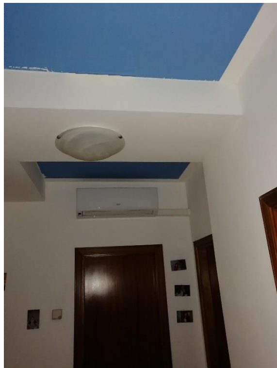
Passaggio canali nel disimpegno
