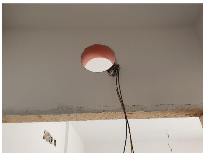
Punto di installazione unità interna freeAirPlus su parete tra camera e disimpegno
