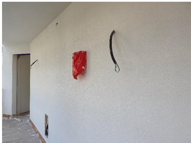
Punto di installazione esterno per ripresa ed espulsione
