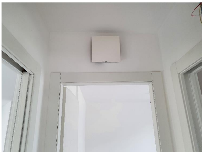
Unità interna freeAirPlus in camera
