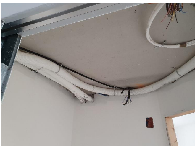
Passaggio canali nel disimpegno
